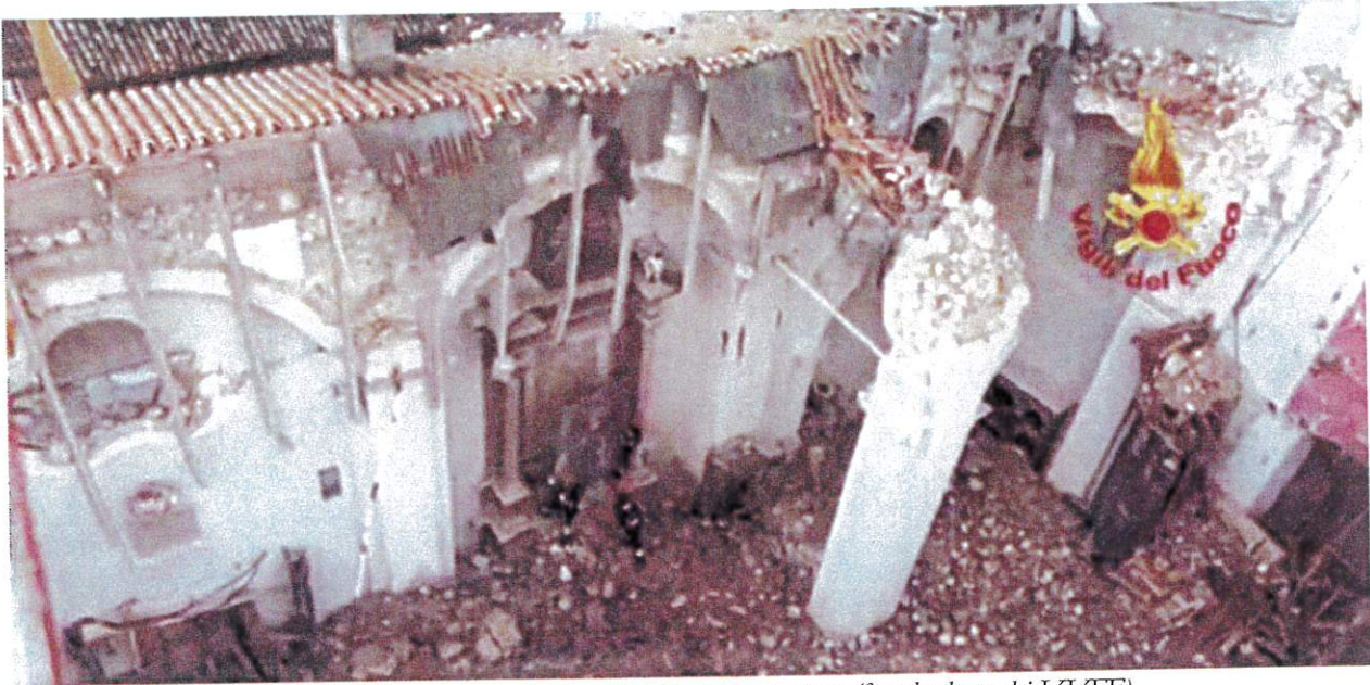
Figura 25 Chiesa di S. Maria Argentea a Norcia dopo il crollo della copertura (foto da drone dei VVFF).
